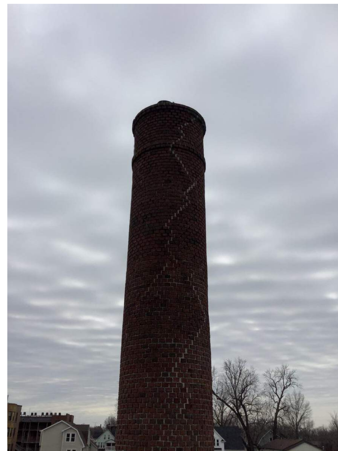
B5 EXISTING CONDITION SCALE: 1" = 1'-0"
